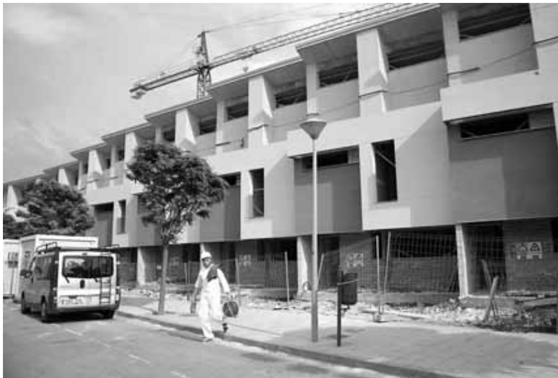
Una imagen de las viviendas, próximas al parque de la Champiñonera de Tudela.
